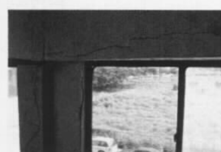
梯廳樑柱龜裂
