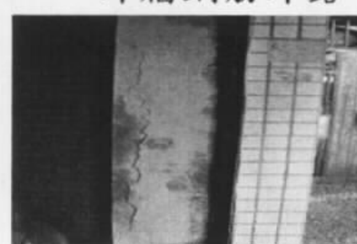
地下室柱爆裂
