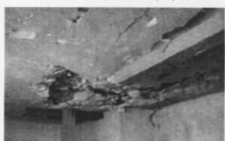
天花板鋼筋外露
