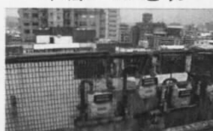
屋頂瓦斯表及管線
