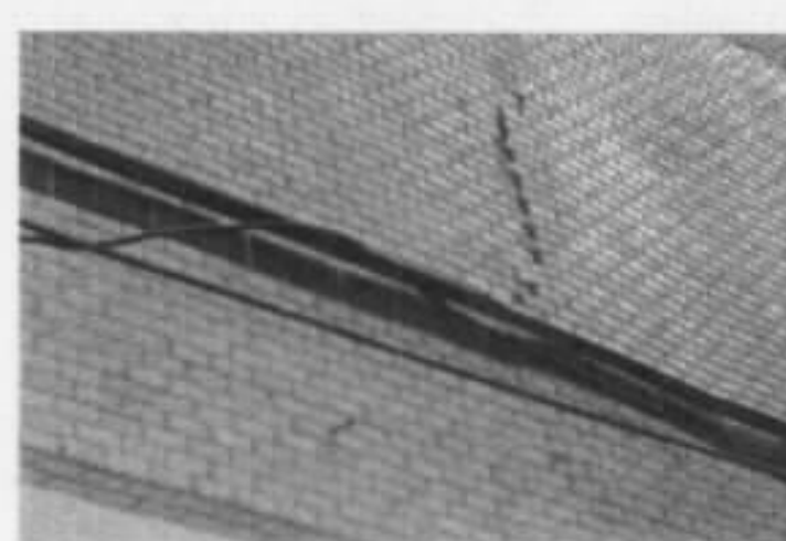
外牆立面龜裂
