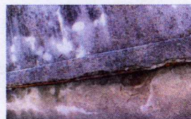
屋頂鋼筋外露
