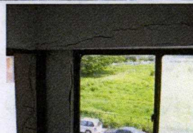
梯廳樑柱龜裂
