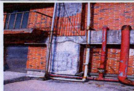
外牆磁磚掉落
