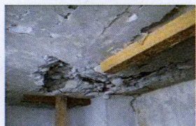
天花板鋼筋外露
