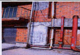
外牆磁磚掉落
