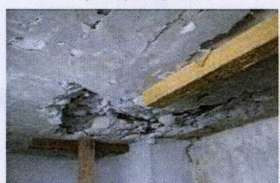
天花板鋼筋外露
