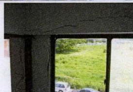
梯廳樑柱龜裂
