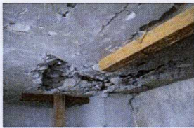
天花板鋼筋外露
