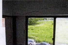
梯廳樑柱龜裂
