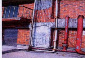
外牆磁磚掉落
