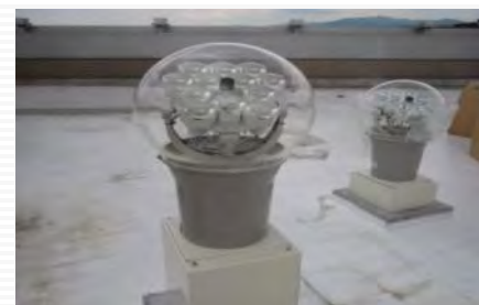
屋頂再生能源 (太陽能光纖導光管)
